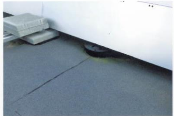
Figur 6.1: Afløb skal være tilgængelige, så de kan renses 1-2 gange årligt. Dette er særlig vigtigt ved UV-afløb. Der mangler fastgørelse af ballasten.
